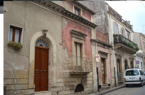
Interventi di manutenzione non omogenei
